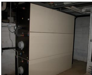
Ballon de stockage
