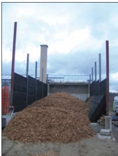
Le silo à plaquettes, bâche repliée pour la livraison
