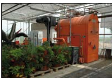
La chaudière bois
