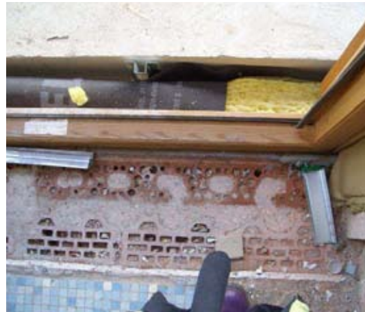
Défaut constaté : laine de verre non protégée avec risque d'humidité
