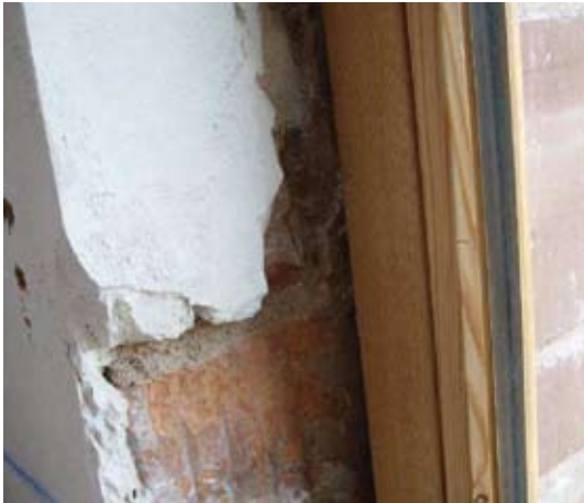
Défaut rencontré : étanchéité à la jonction dormants/chassis
