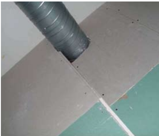
Défaut rencontré : jonction entre murs et réseau de ventilation
