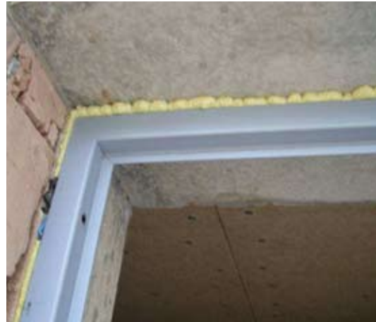
Défaut rencontré : utilisation de mousses pour reboucher, colmater le trou
