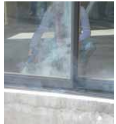
Les menuiseries coulissantes standard présentent généralement d'importantes fuites d'air mises en évidence à l'aide de fumigènes lors de test d'infiltrométrie.
