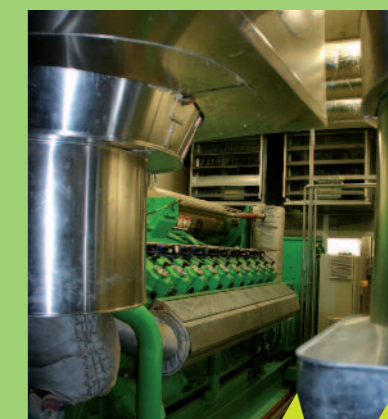
Le moteur de cogénération qui produit à la fois la chaleur et l'électricité avec le biogaz issu de la méthanisation.
